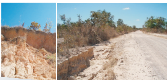
Figuras 51 e 52 - Voçorocas decorrentes de más condições de drenagem
